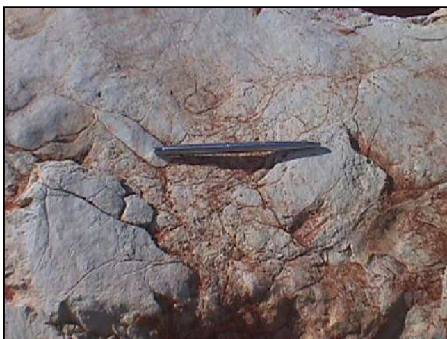
Fig. 10. Patrones de agrietamiento en la superficie de las calizas de la Fm. Cojímar.
